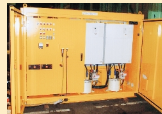
インバータ制御盤
