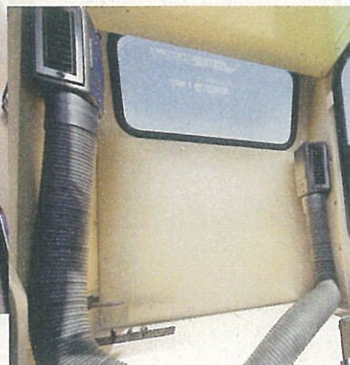
▲エアコンダクト
